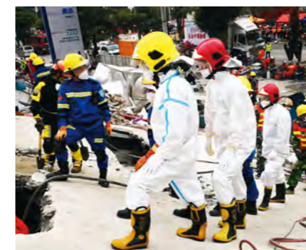
△ 泉州石化应急基地参与泉州欣佳酒店“3·7”坍塌事故救援现场
